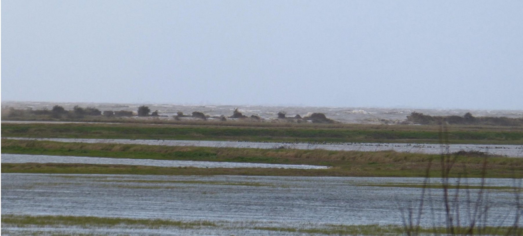
Coup de mer du 9 février 2016 – Moëze – digue submergée, dégâts importants
