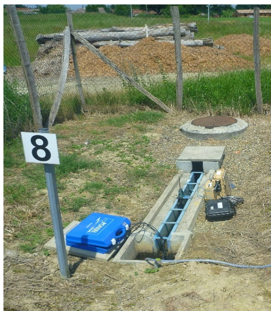
Canal venturi normalisé
