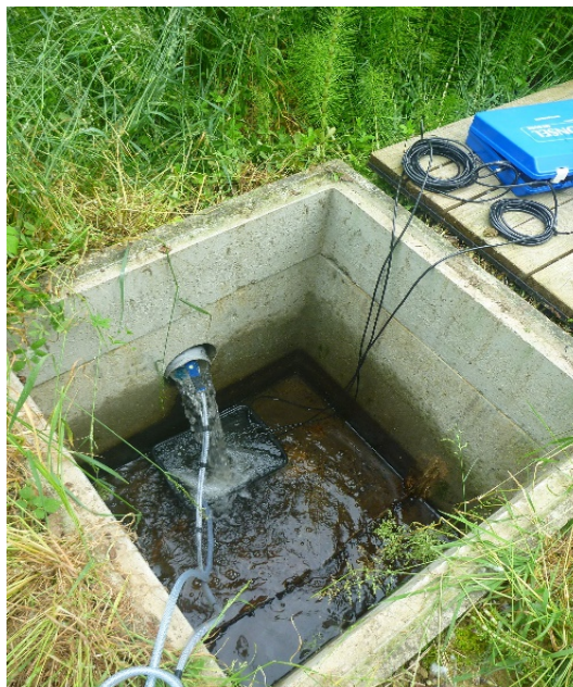
Large regard avec chute
