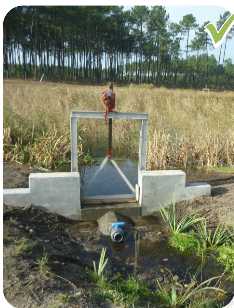
Martellière avec vanne permettant vidange (réalisation SUEZ)
