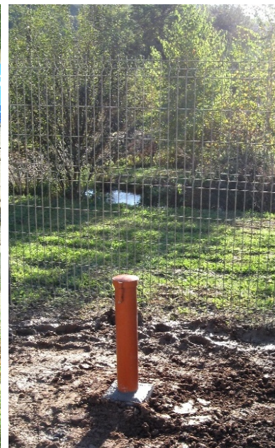
Piézomètre de contrôle
