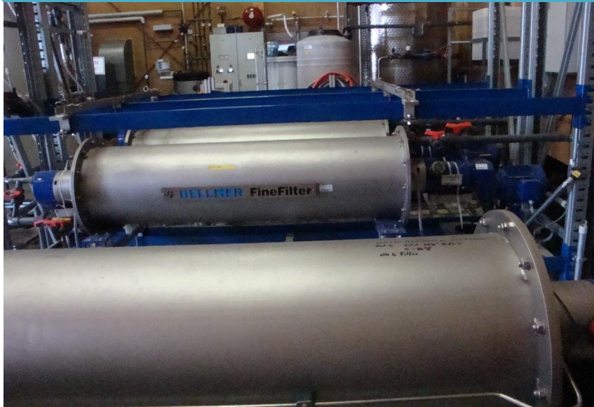
Module membranaire digesteur ligne eau
