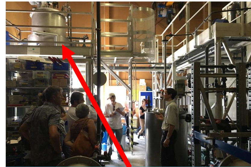
Digesteur ligne boue
