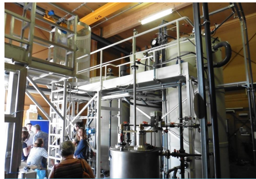
Décanteur et digesteur ligne eau
